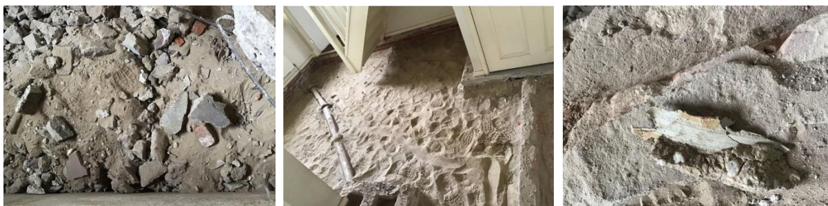
Figuur 2: Risicovolle situatie door ondeskundig verwijderen betonvloer met asbesthoudend vloerzeil
